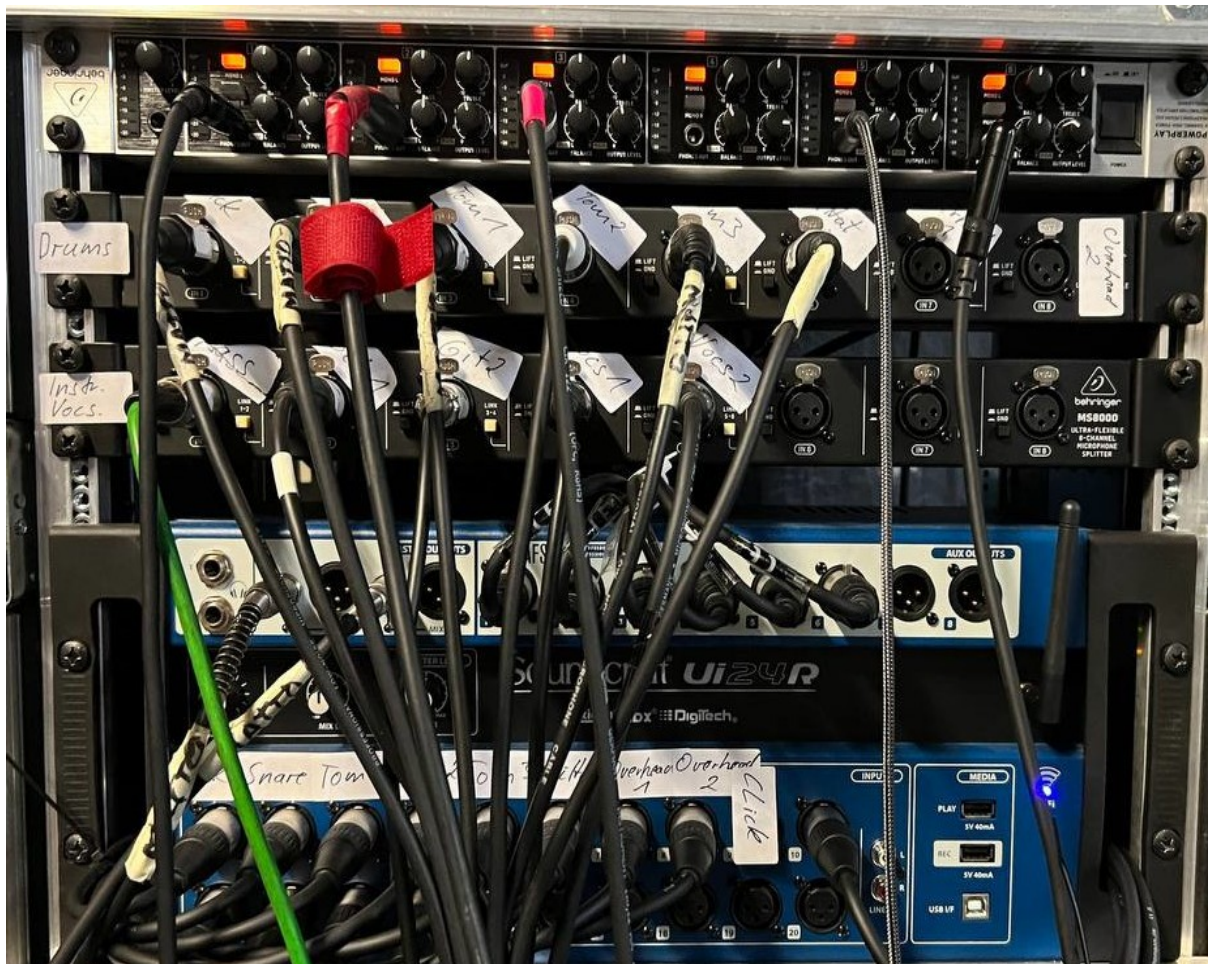
Schaubild 1: Rack mit Kopfhörerverstärker (oben), Splitbox 1 für Drum-Mikrofonierung (darunter), Splitbox 2 für Instrumenten- und Vocal-Mikrofonierung (Mitte) und Soundcraft UI24R (ganz unten, blau).
